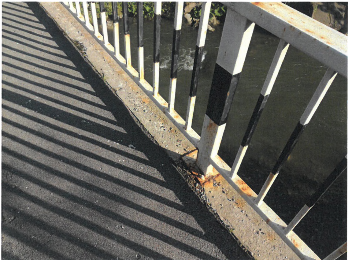
Foto nr. 12 – Degradarea elementelor de prinderea a parapetul pietonal
