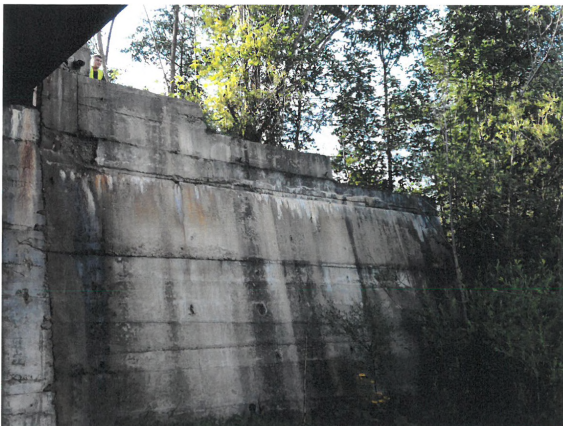
Foto nr. 5 - Cumularea la un element al structurii a mai multor degradări (coroziunea betonului și a armăturii, exfoliere, fisuri, crăpături, striviri) care se manifestă prin modificarea formei elementului și a proprietăților fizico-mecanice ale materialelor
