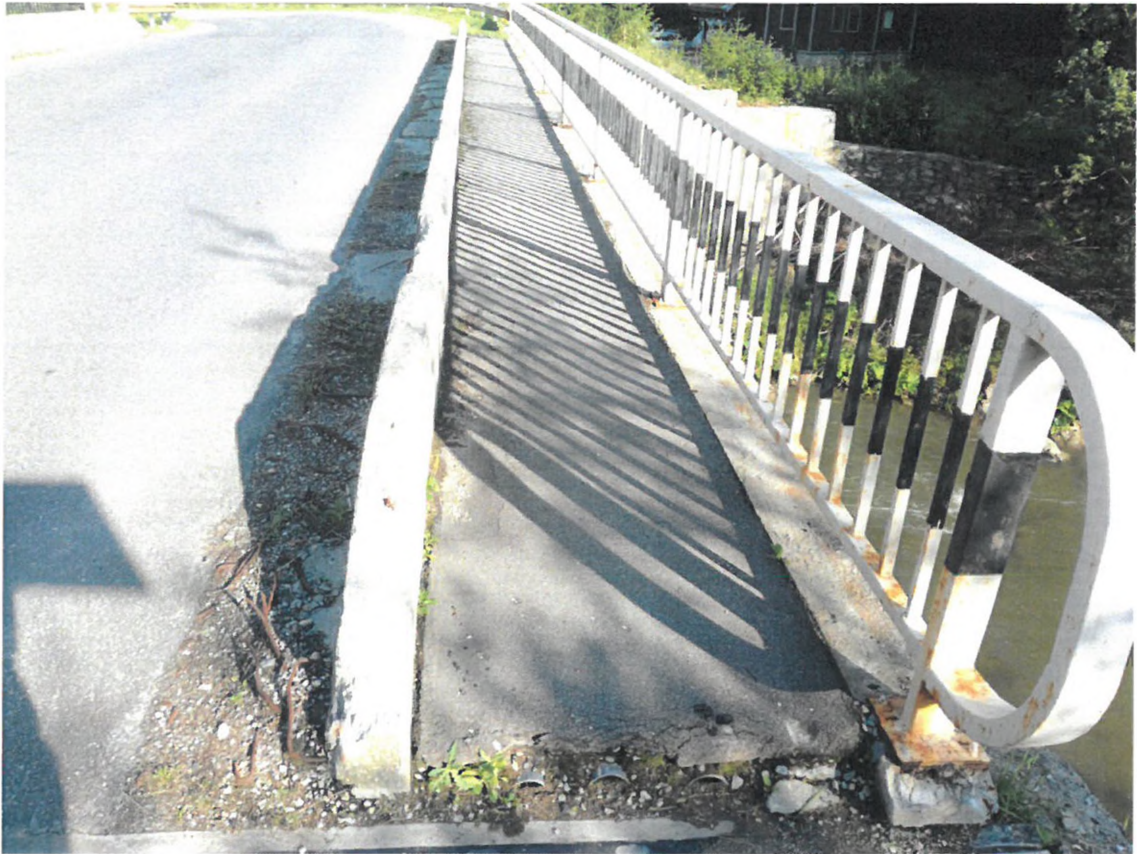
Foto nr. 11 – Lipsa parapetului de siguranță și/sau a unor elemente din parapetul podului
