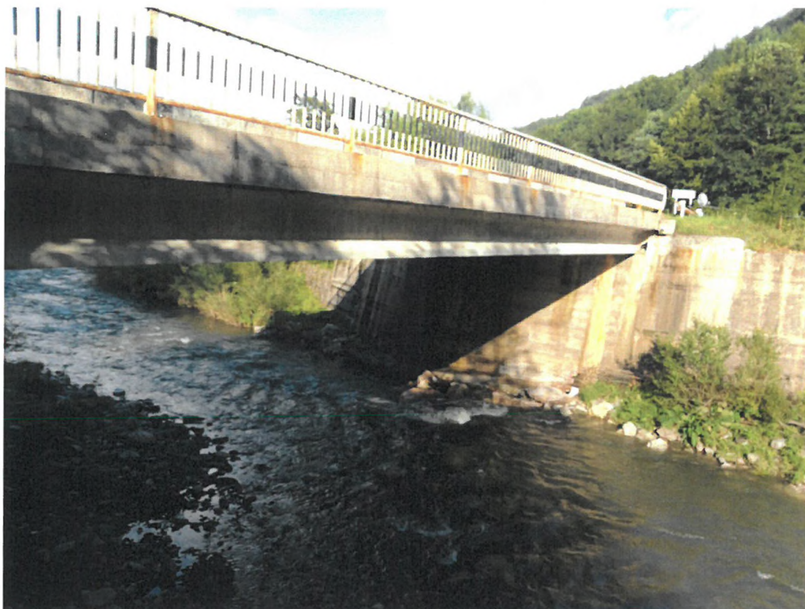
Foto nr. 7 – Modificări ale regimului hidraulic, coborârea etiajului în zona podului, afuierea infrastructurilor
