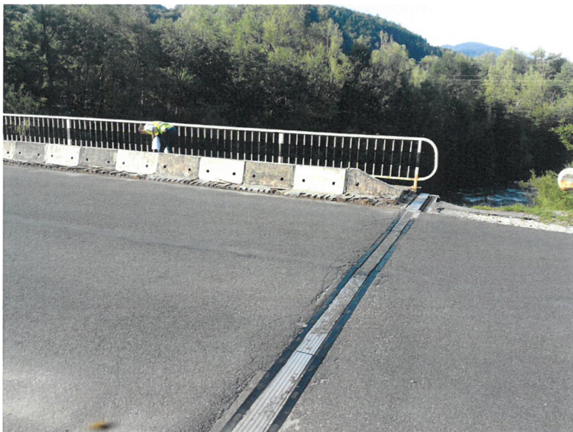
Foto nr. 8 – Distrugerea dispozitivului de acoperire a rosturilor pe culei, fisuri și crăpături, infiltrații în zona rosturilor de dilatație
