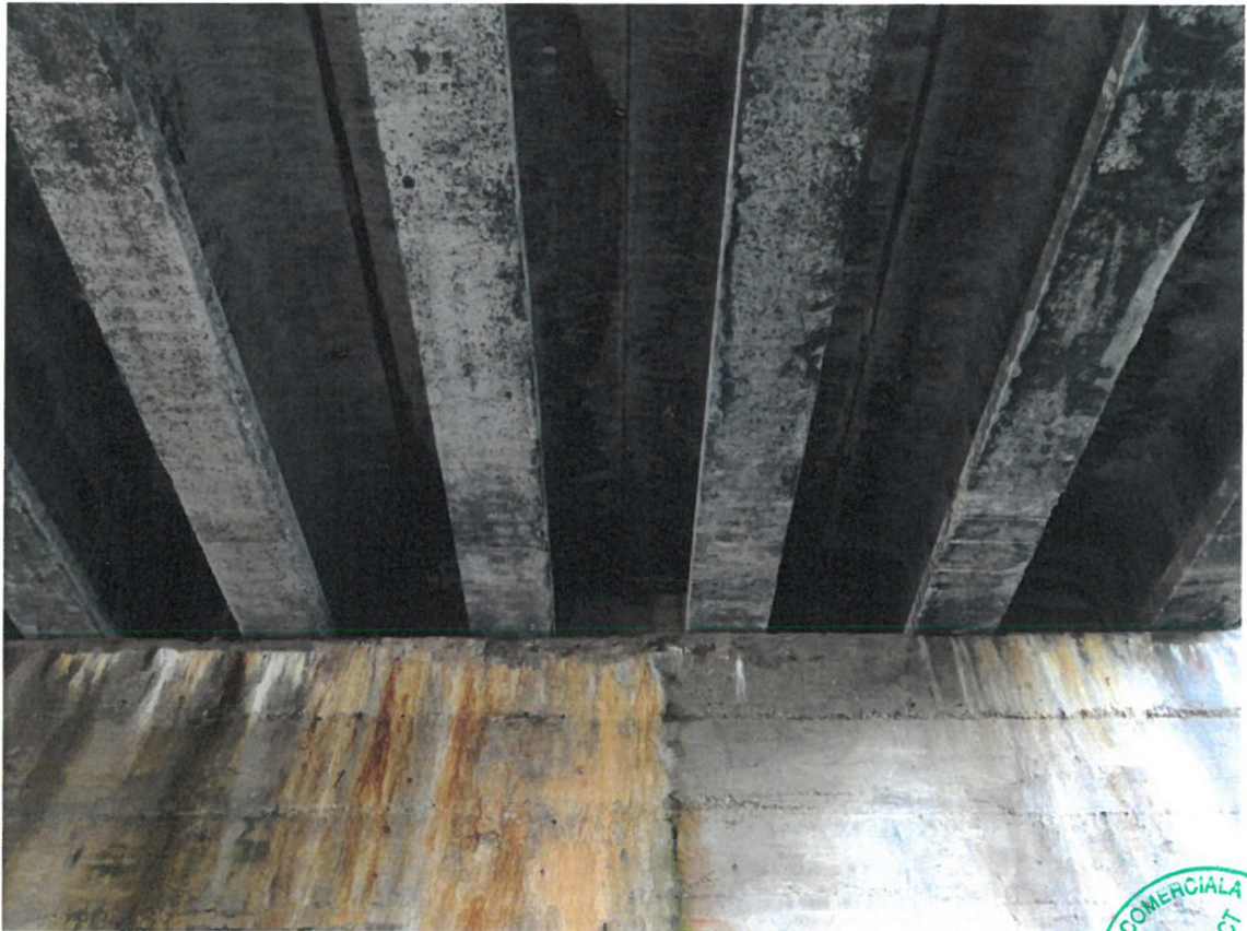
Foto nr. 1 - Beton degradat prin carbonatare
