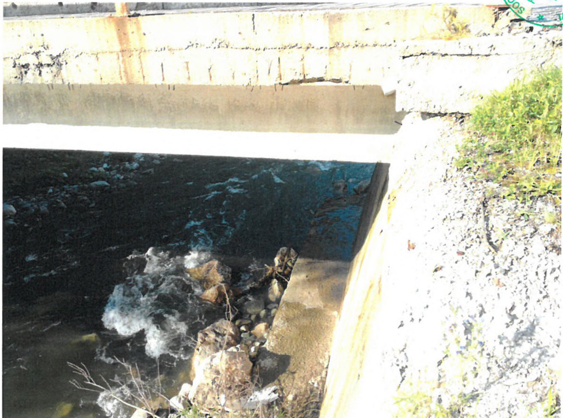
Foto nr. 2 – Armături fără strat de acoperire
