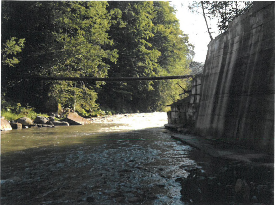
Foto nr. 13 – Degradări ale malurilor, colmatarea și modificări ale traseului albiei râului Jiul de Vest
