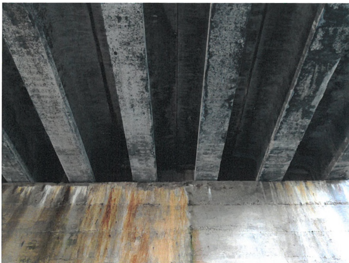
Foto nr. 4 – Beton degradat prin carbonatare, apariția de stalactite și/sau draperii
